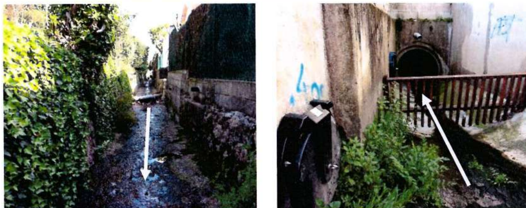
Figure 8 : Photographies du Riou entre le chemin du Pérrier et le boulevard du Four à Chaux et du dégrilleur
