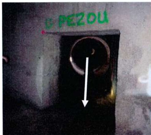
Figure 14 : Photographie de la confluence entre le Pezou et la Foux - Radier dégradé
