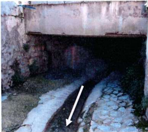
Figure 18 : Photographie de la partie souterraine sous le rond-point au droit de la rue Frédéric Mistral et de l'avenue de Lacour
